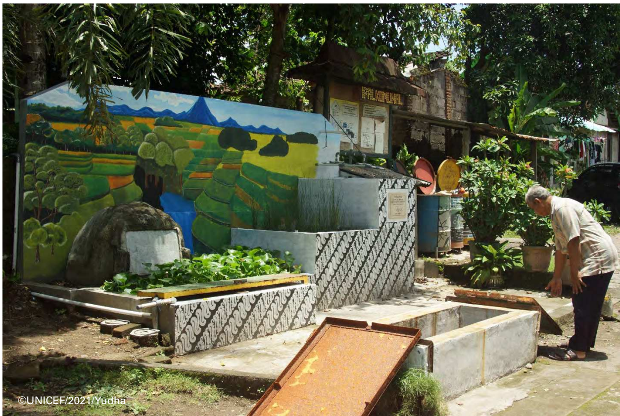
Gambar 9: Seorang warga sedang mengontrol instalasi pengelolaan air limbah komunal (IPAL) di Desa Wisata Lingkungan Sukunan Yogyakarta
